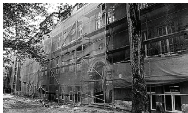
■ До конца лета строителям нужно закончить ремонт фасада «ШИЛИ» и навести здесь порядок
