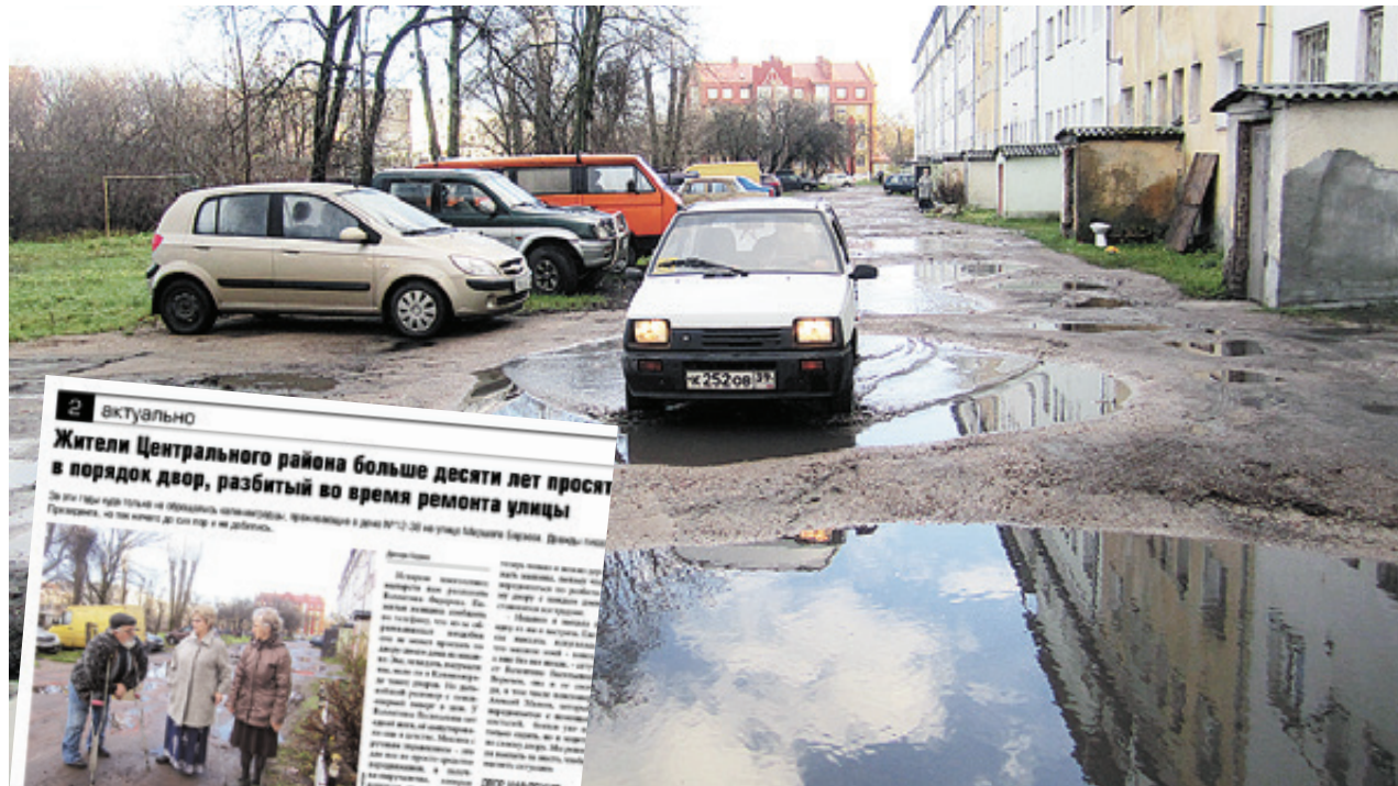
■ Во время ремонта в 2007 году дорожного полотна на ул. Борзова по двору в объезд пустили транспорт
